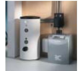
Heizungs- und Warmwasserwärmepumpen
